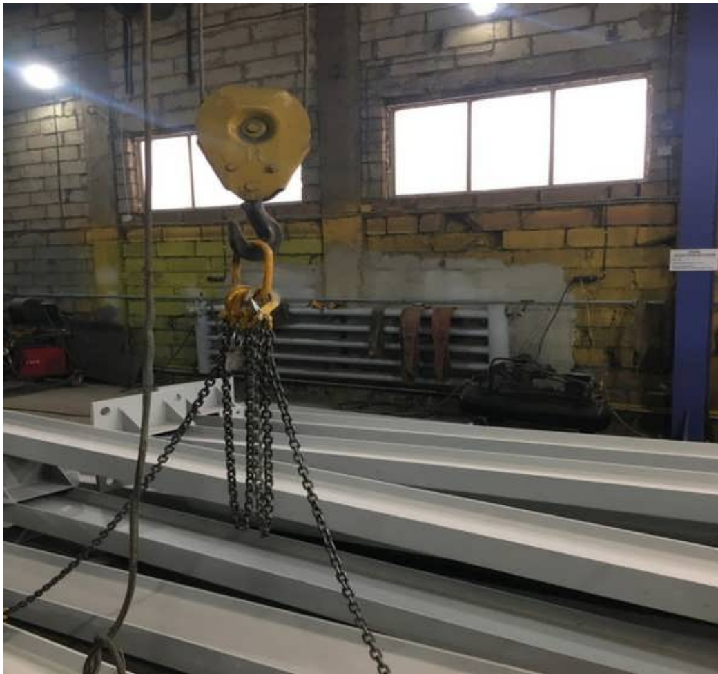
На электрической тали грузовой крюк не снабжен предохранительным замыкающим устройством, предотвращающим самопроизвольное выпадение грузозахватных элементов стропов, траверс и других грузозахватных средств
