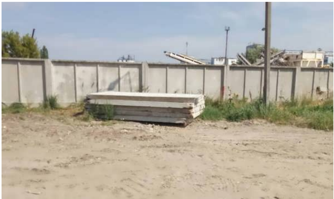
Железобетонные плиты уложены без подкладок и прокладок
