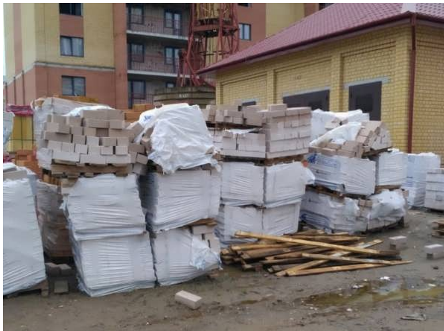
Площадка для складирования без твердого покрытия, не обеспечена устойчивость материалов
